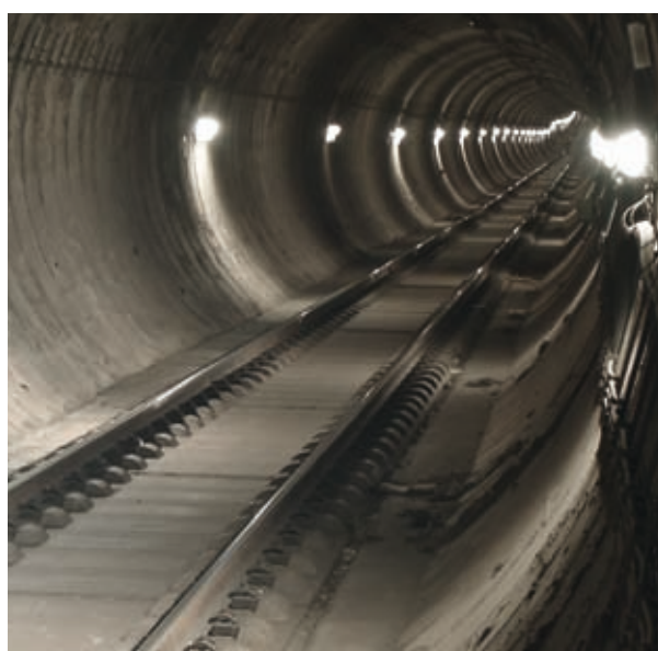
Einsatz von mikrozellularen Pads und Schwellenschuhen. Øresundbücke, Dänemark-Schweden und Eurotunnel, Frankreich-Großbritannien.
